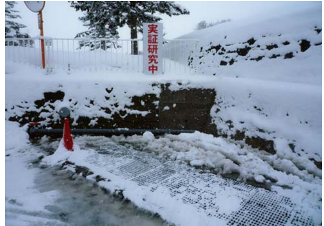
市役所がつくった流雪溝。
